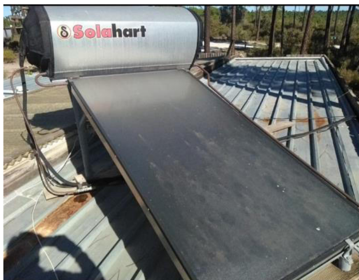
Fotografia 4.6 – Sistema solar térmico tipo termossifão
