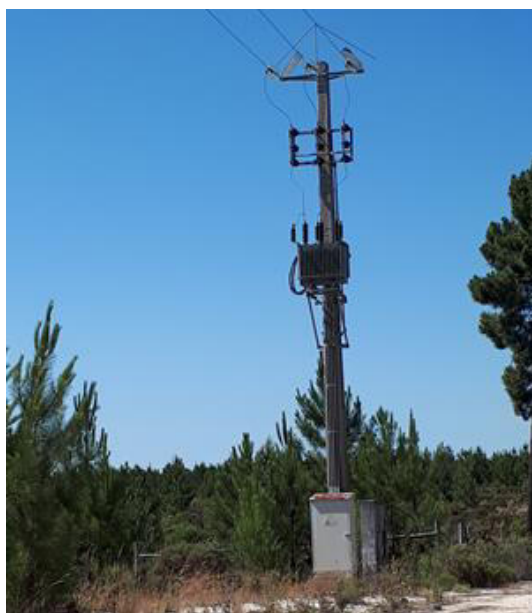
Fotografia 4.4 – Posto de transformação existente no exterior da propriedade
