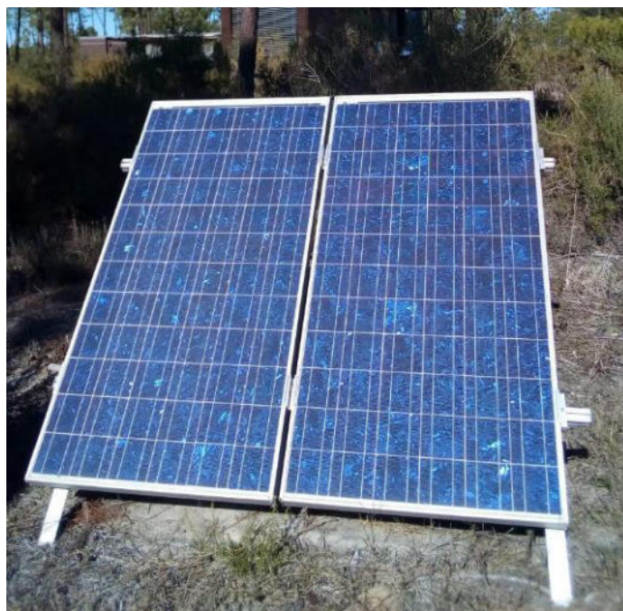
Fotografia 4.5 – Sistema solar fotovoltaico instalado
